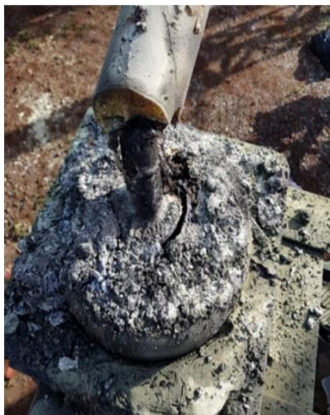
Gambar 63 Kerusakan pada CSE
