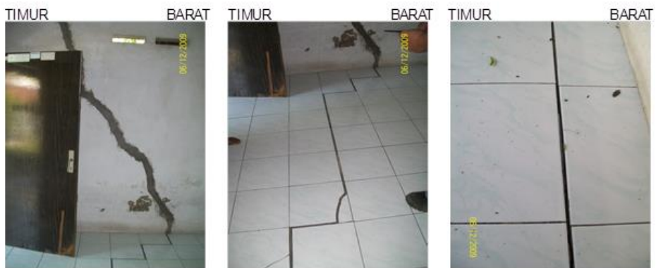
Gambar 17 Retakan bangunan di STA 19, arah retakan cenderung Utara – Selatan
