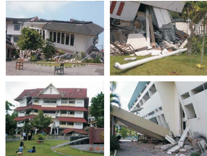
Gambar 2. Gambaran kerusakan bangunan hasil survey gempa Yogyakarta tahun 2006 dan Sumatra Barat 2009. (Sumber: Laporan hasil survey pasca bencana gempa, dalam Sengara et al., PMB-ITB 2006, 2009)
