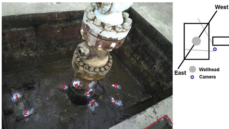
Gambar 15 Titik kebocoran yang terdeteksi di kotak cellar dan kepala sumur permukaan.
