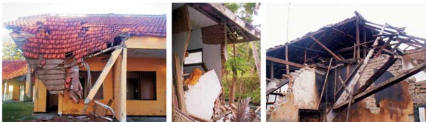
Gambar 3.4.: Kerusakan Bangunan dikarenakan Sistim Sambungan antar komponen yang tidak solid
