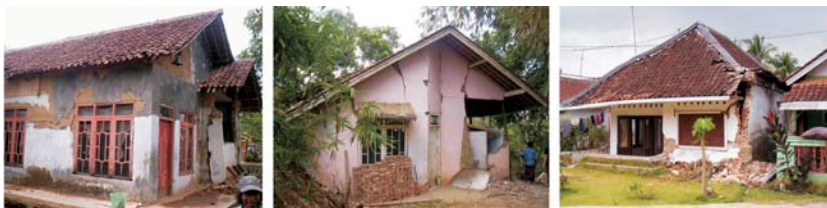
Gambar 3.1.: Kerusakan Bangunan dikarenakan Bentuk Bangunan dan Pembagian Ruang Dalam yang Kurang Proporsional
