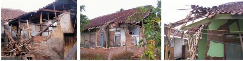
Gambar 3.3.: Kerusakan Bangunan dikarenakan Pondasi tidak Kuat
