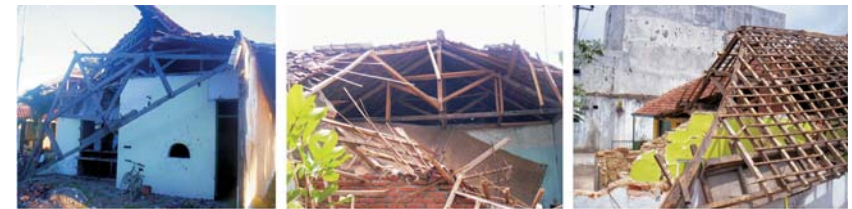
Gambar 3.2.: Kerusakan Bangunan dikarenakan Struktur Bangunan Tidak Kuat
